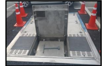
INVERTER-1 (전기차 충전기)
